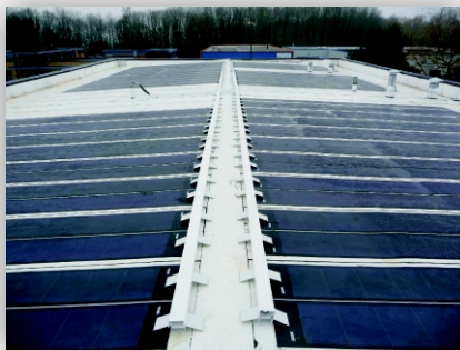
Un aperçu des panneaux photovoltaïques souples disposés sur le toit de la salle de musique
